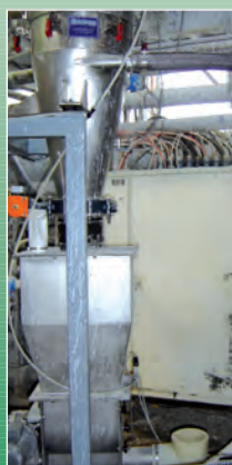
Doseur alimenté par transfert pneumatique
