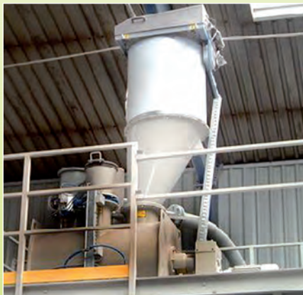
Dépoussiérage du mélangeur
