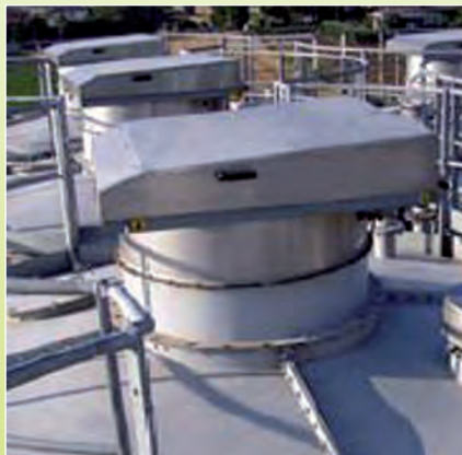
Filtre intégré dans le silo
