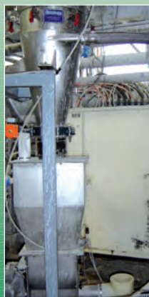
Doseur alimenté par transfert pneumatique
