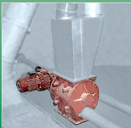
Alimentation transfert pneumatique
