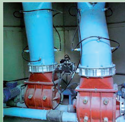
Alimentation transfert pneumatique
