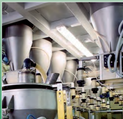
Ensemble de dosage automatisé
