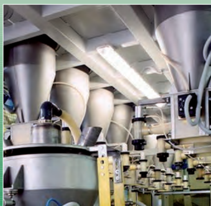
Ensemble de dosage automatisé
