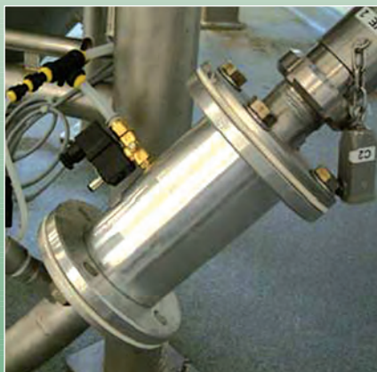
Vanne de coupure sur ligne de transfert pneumatique
