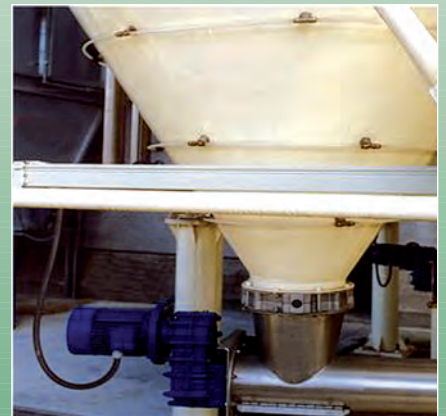
Vanne sous silo fluidisé pour maintenance
