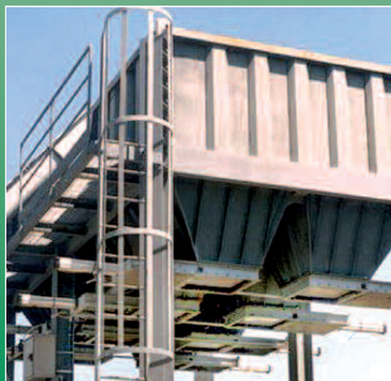
Vanne sous trémie de chargement
