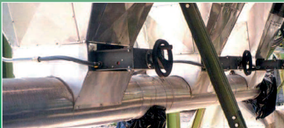
Vanne manuelle sous silo
