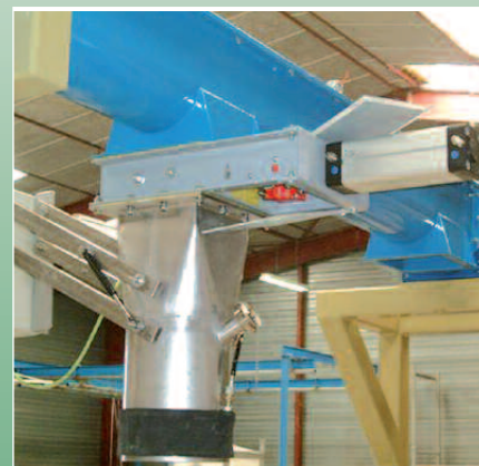
Vanne pneumatique sous vis de transfert pour remplissage de big bags
