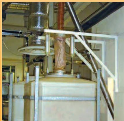
Station de remplissage confinée
