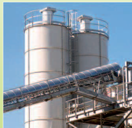
Filtre bridé en extérieur silo
