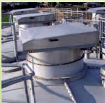
Filtre intégré dans le silo
