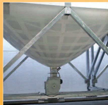
Sortie silo pour alimentation transfert pneumatique
