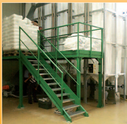
Silo de stockage avec craquage des sacs de granulés PE
