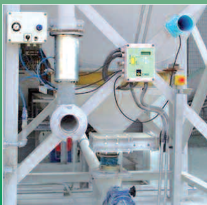
Pieds de chargement silo
