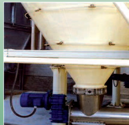
Vanne sous silo fluidisé pour maintenance
