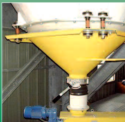
Vanne sous silo fluidisé pour régularisation de débit
