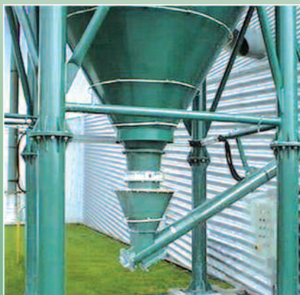
Vanne sous silo
