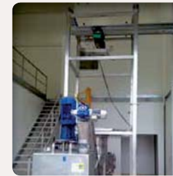
Connexion sur cuve liquide
