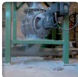
➤ Alimentation transfert pneumatique
