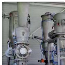
➤ Sous cyclone, transfert de résine
